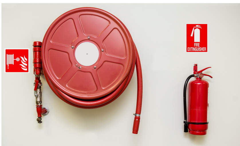
Reparos ou substituição de dispositivos de bombeiros,
